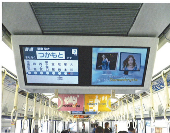
車内広告映像「WESTビジョン」
